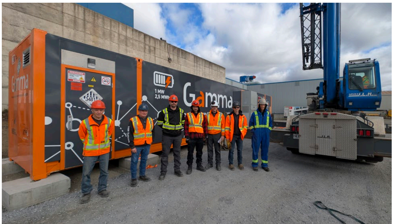
Des employés du Groupe NBG, de IDEA Contrôle et de Grues JLR posent devant le nouveau système énergétique Gamma au moment de son installation.
